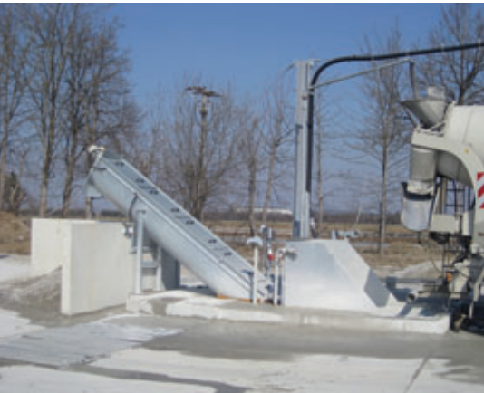
Das neue Bibko-Restbetonrecyclingsystem bei Berger Beton in Unterbrunn
