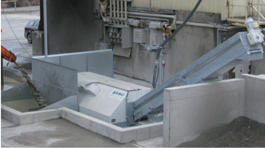
Bibko-Restbetonrecyclinganlage der Heidelberger Beton Karlsruhe GmbH & Co. KG, Werk Karlsdorf
