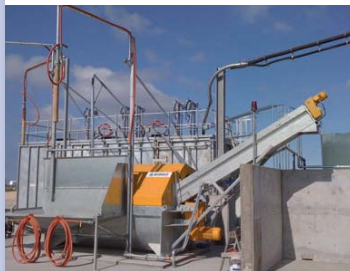
Bibko-Restbetonrecyclinganlage mit Wendelförderer
