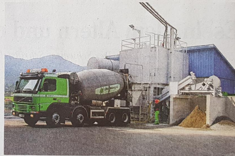
Die Recyclingsysteme der Beilsteiner Firma Bibko ermöglichen die Wiederverwertung von Flüssigbeton. Im Bild sieht man die Trennung von Sand und Kies. Foto: Bibko
