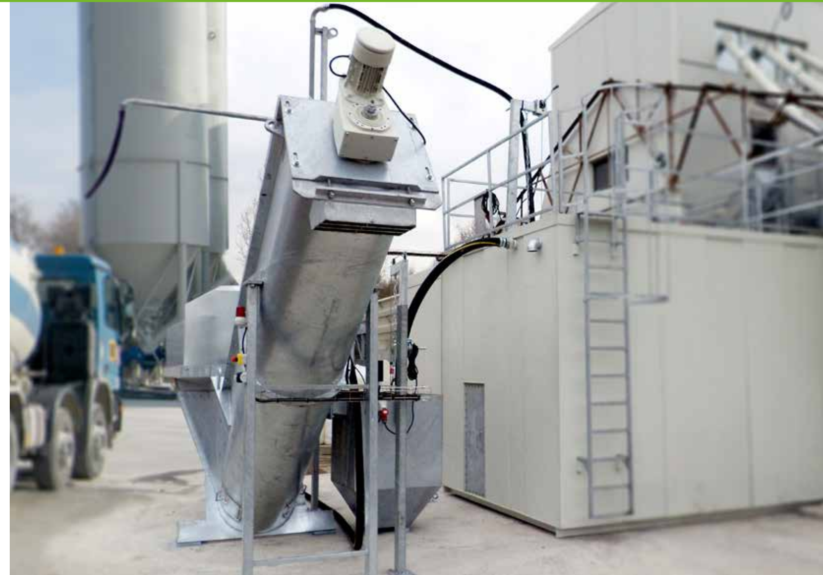
RWS auf Bodenniveau, mit oberirdischem Stahltank RWS set at ground level, with above ground steel tank
